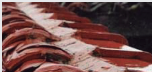
Desconchados en teja cerámica por falta de microventilación
