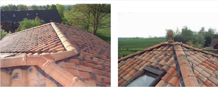
Cumbrera y limatesas ventiladas para evitar daños por acumulación de humedad
