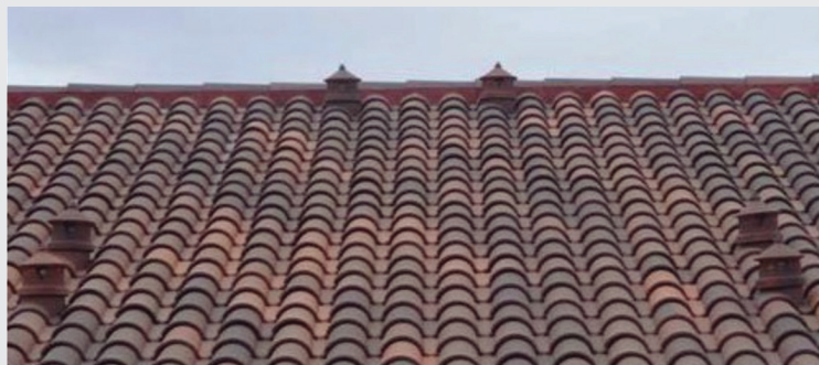
Chimeneas de ventilación. Posición desencontrada
