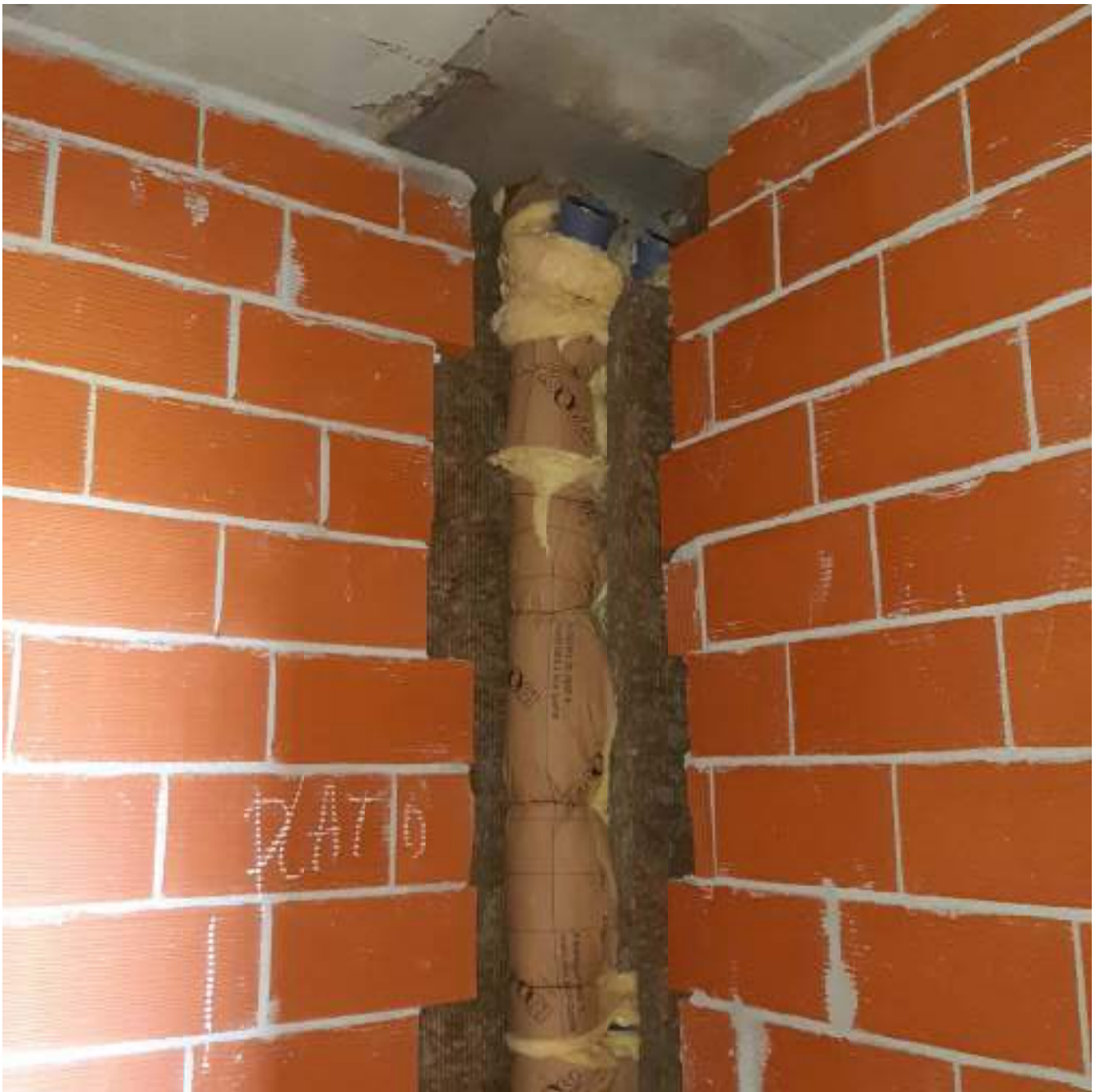
Encuentro entre paredes medianeras entre viviendas y bajante.
