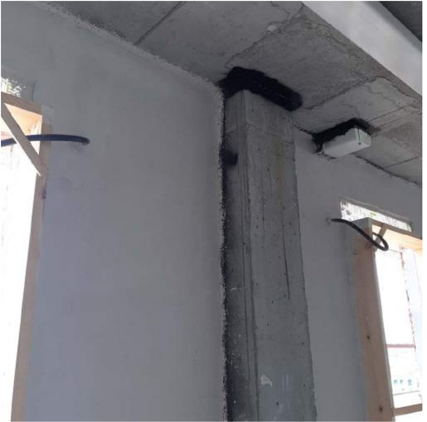
Recubrimiento interior de yeso de la cara interior de la hoja exterior de ladrillo.
