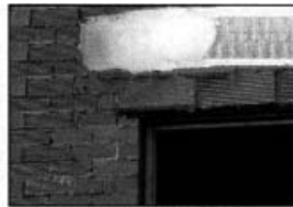
Recubrir totalmente las cajas de persiana con la malla y 20 cm cada unión de la misma con un cerramiento
